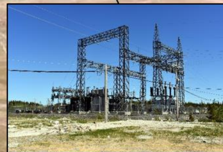
Poste électrique de 50 MW
