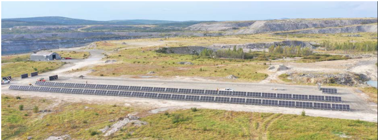
Figure 1. 500 panneaux solaires ont été installés. Ils seront reliés au camp de Troilus afin de servir de source d'énergie supplémentaire et de secours.
